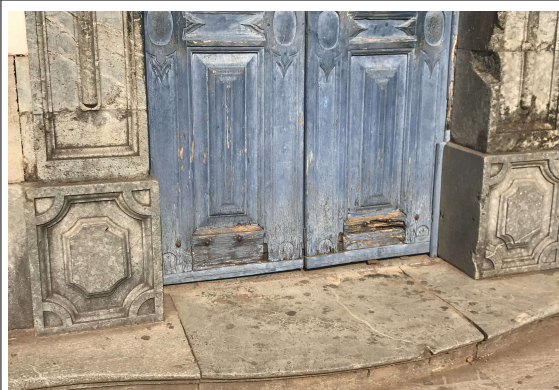
Figura 09 - Comprometimento do trecho inferior das esquadrias.
