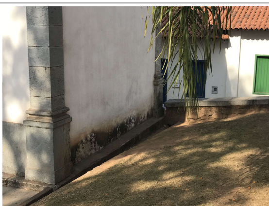
Figura 04 - Manchas de umidade nas alvenarias dos Passos.
