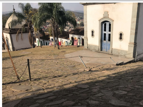
Figura 12 - Danos no cercamento do jardim.
