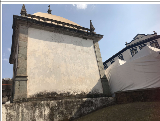
Figura 03 - Manchas de umidade nas alvenarias dos Passos.
