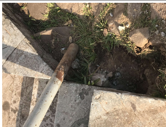
Figura 13 - Danos no encaixe dos balizadores no solo.
