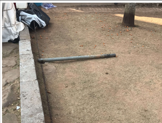
Figura 14 - Danos no cercamento do jardim.
