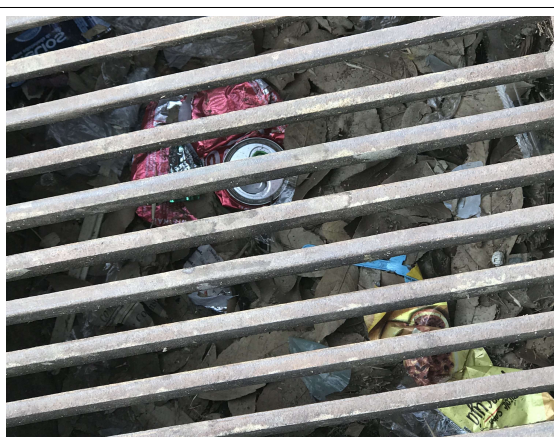
Figura 02 - Lixo no interior das grelhas.
