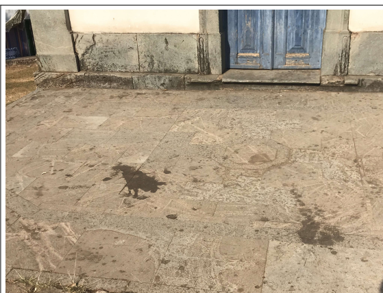
Figura 01 - Sujeira no piso existente no entorno dos Passos.
