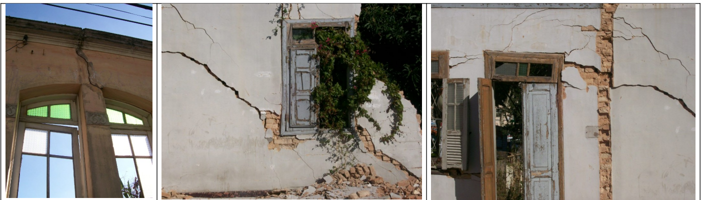
Figuras 12, 13 e 14 - Trincas que sinalizam a desestabilização das paredes.
