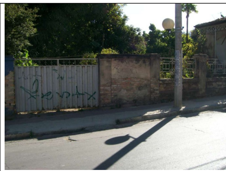
Figura 26 – Descolamento do reboco do muro e pichações.
