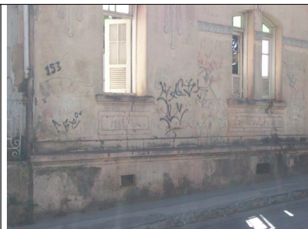
Figura 27 – Pichações, sinais de umidade e sujidades.
