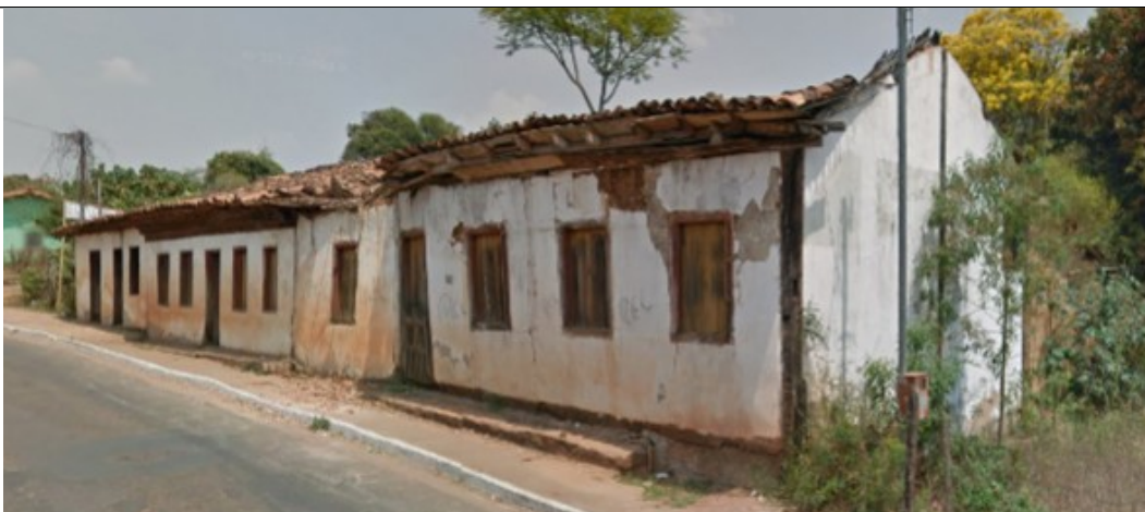
Figura 08 – Imagem do imóvel em estado de degradação, datada de setembro de 2012. Fonte: Google Street View.
