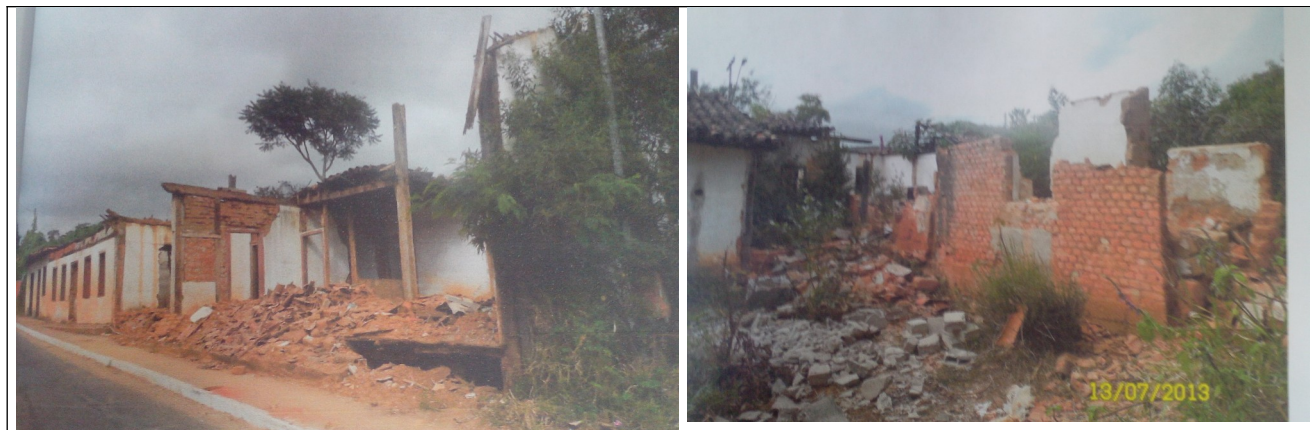
Figuras 12 e 13 – Imagens dos imóveis em estado de degradação, datada de julho de 2013.
