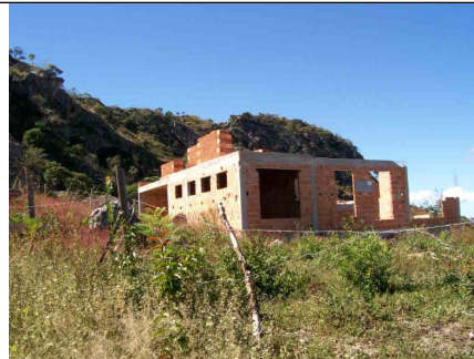
Figura 13 – Construção irregular com obra embargada.
