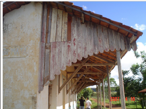
Figura 13 – Tabuado recortado na fachada lateral.
