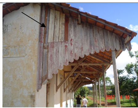
Figura 22 - Emendas mal feitas na proteção em tabuado recortado de madeira.
