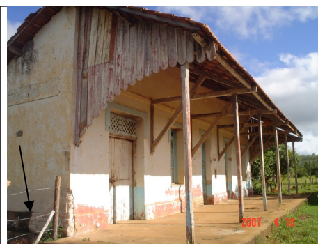
Figura 21 – Fachada frontal com descolamento de pintura, sujidades e descolamento do reboco (seta).
