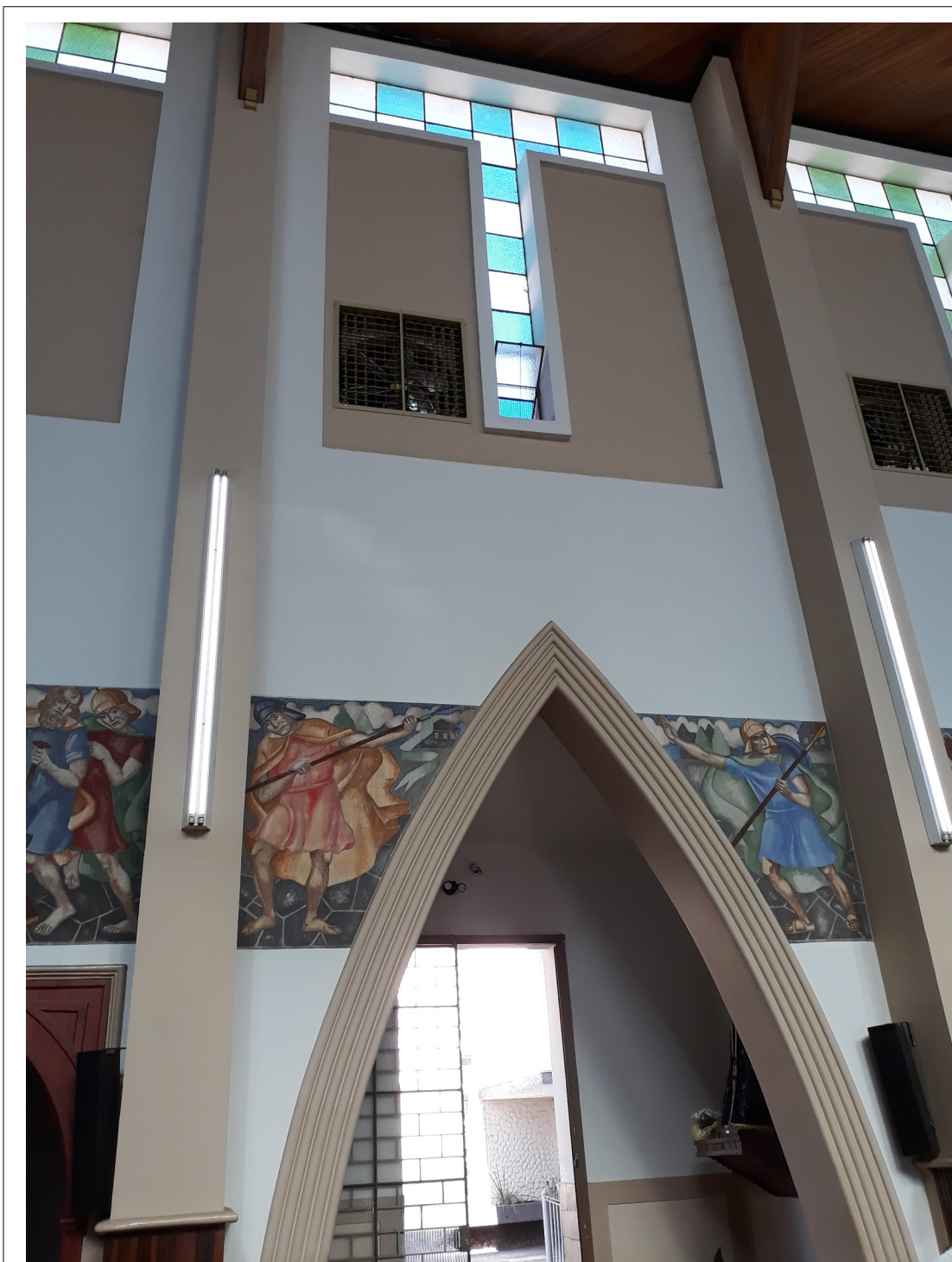
Figura 9 – Visada que permite verificar a distância entre a pintura parietal e o sistema de climatização instalado no interior do Santuário. Fonte: CPPC.
