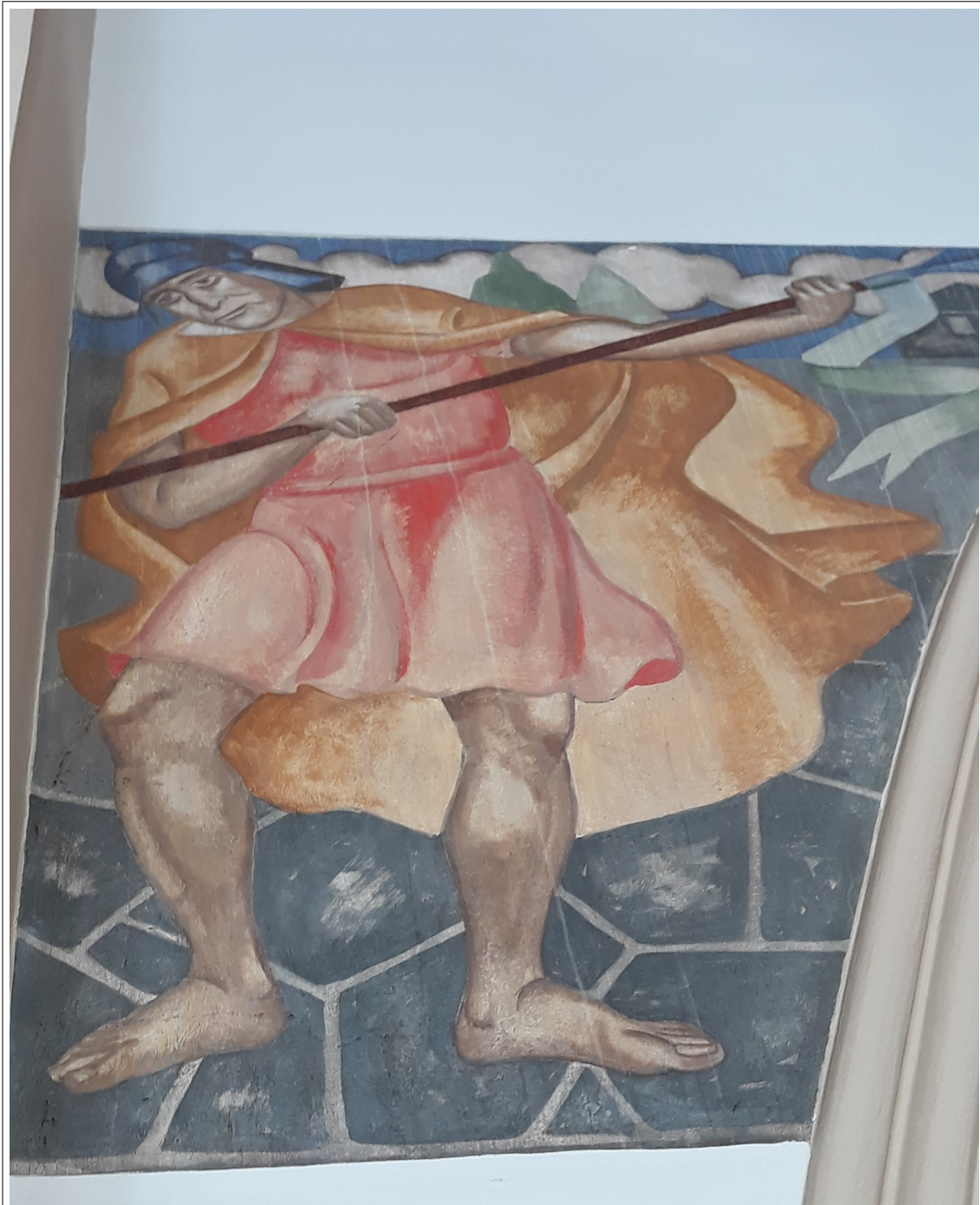
Figura 10 – Detalhe do registro fotográfico apresentado na figura 9. Observa-se a presença de linhas esbranquiçadas. Importante tomar nota, ainda, que este enquadramento da obra encontra-se imediatamente abaixo do sistema de climatização. Fonte: CPPC.
