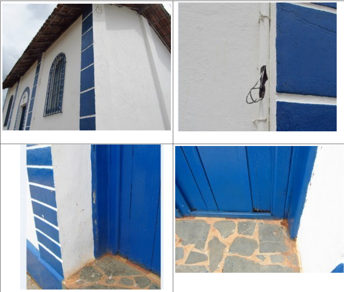
Figuras 19, 20, 21 e 22- Patologias identificada na parte externa da Capela do Cruzeiro. Fotos da vistoria.
