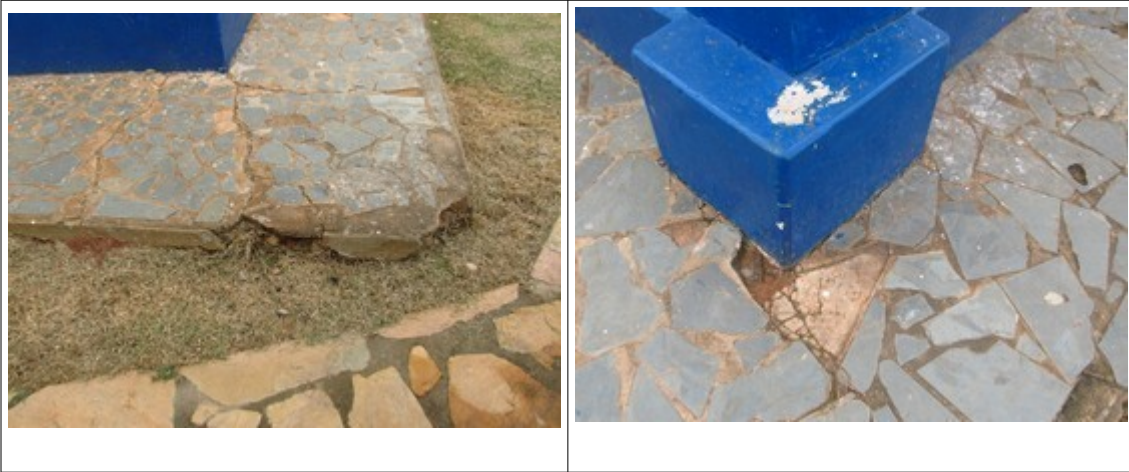
Figuras 17 e 18- Danos nos pisos externos da Capela do Cruzeiro. Fotos da vistoria.
