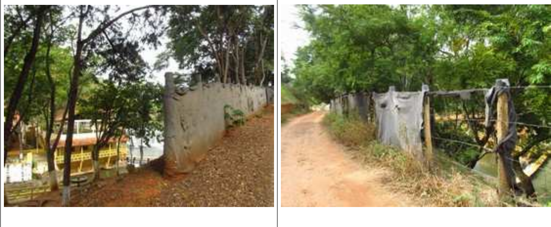
Figuras 32, 33 e 34- Manta geotêxtil instalada nas cercas que circundam o Complexo da Barragem pela Anglo American. Fotos da vistoria.
