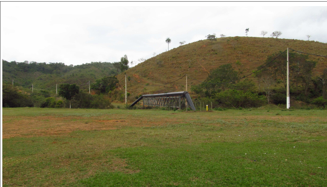
Figura 35- Tubulação instalada na área de camping do Complexo da Barragem. Foto da vistoria.
