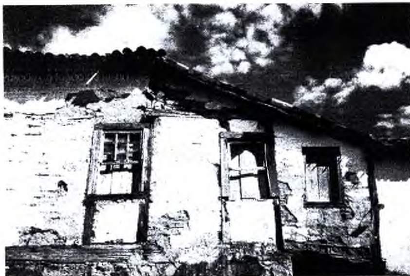
Detalhe das janelas do bloco mais antigo. Os quadros dos vãos são em vergas retas, com folhas de abrir para dentro e calxilhas com guilhotinas na parte externa. A construção se encontra em mau estado de conservação.
