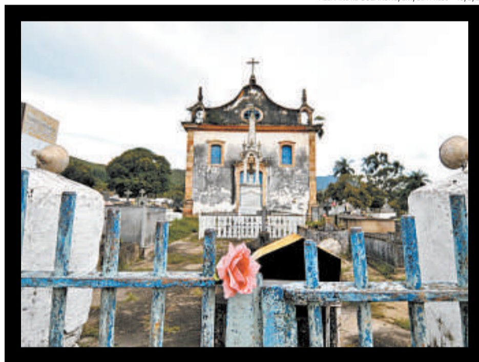
EM ESTADO CRÍTICO, A CAPELA DE NOSSA SENHORA DO ROSÁRIO, EM CAETÉ, É UM DOS TEMPLOS HISTÓRICOS INTERDITADOS EM MINAS GERAIS
