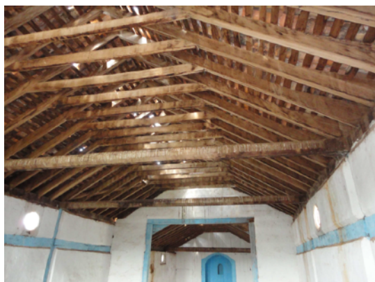
Figura 05 – Imagem interna da cobertura com entrada de luminosidade indicando telhas deslocadas ou quebradas.
