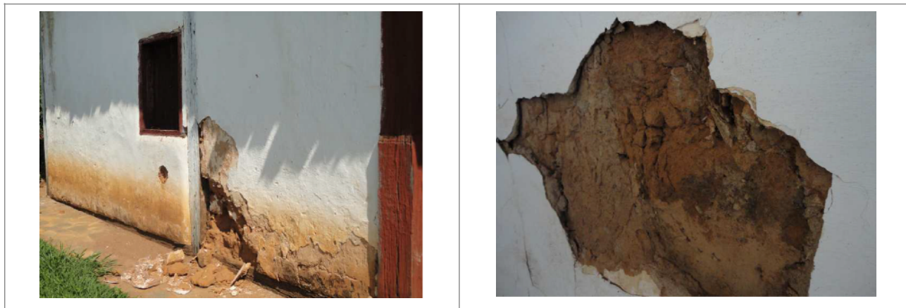
Figuras 07 e 08 – Perdas nas alvenarias e reboco. Fonte: Laudo de Estado de Conservação encaminhado ao IEPHA para o exercício 2012.
