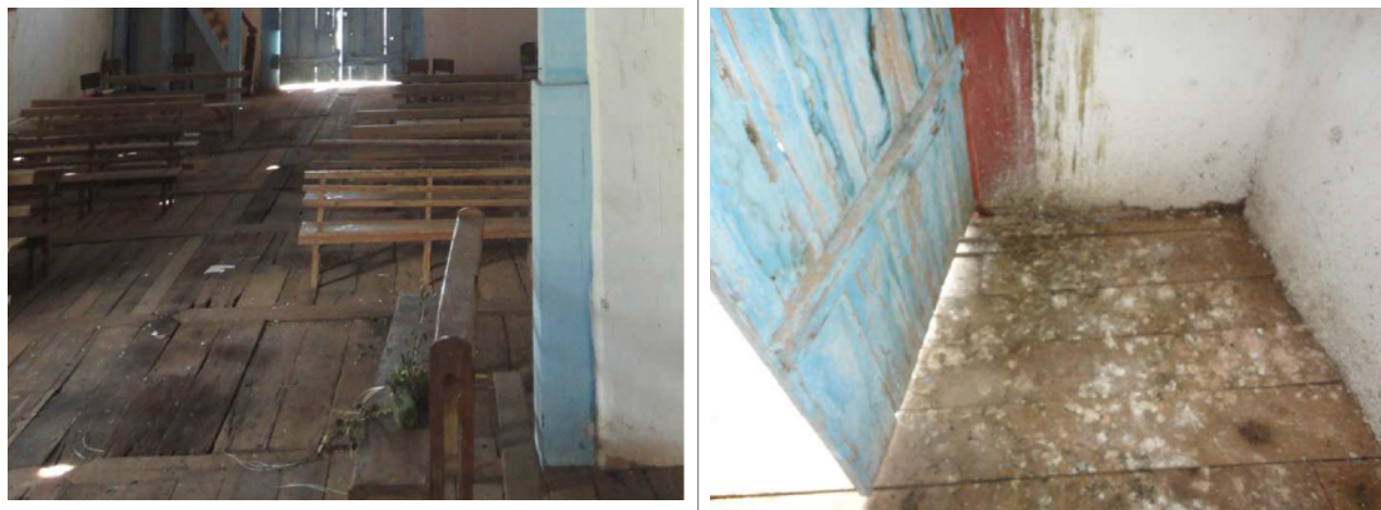
Figuras 11 e 12 – Imagens de patologias nos acabamentos internos e falta de manutenção e limpeza no imóvel.
