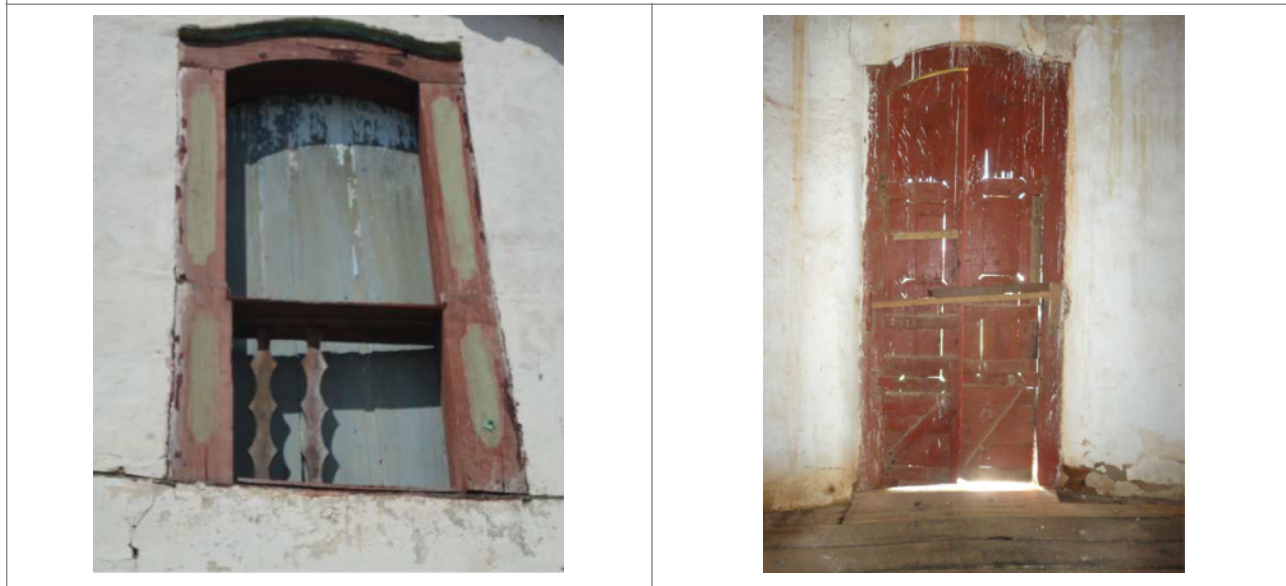
Figuras 09 e 10 – Danos e perdas nas esquadrias. Fonte: Laudo de Estado de Conservação encaminhado ao IEPHA para o exercício 2012.
