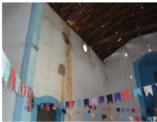
Figura 06 – Mancha de umidade causada por danos na cobertura.
