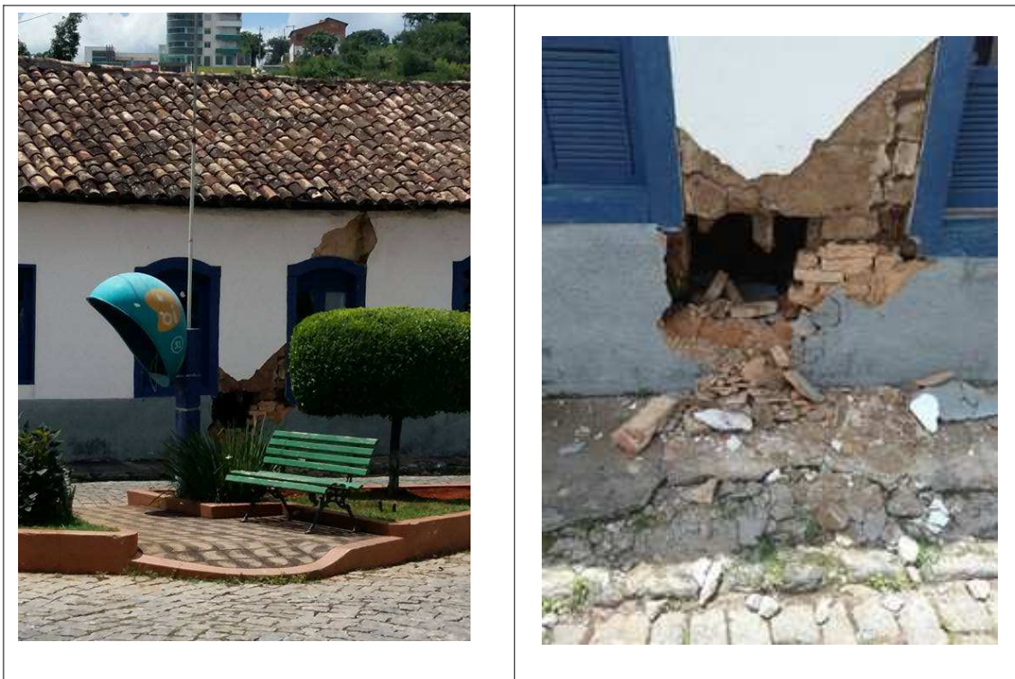
Figuras 9 e 10- Imagens do imóvel após colisão de um veículo.
