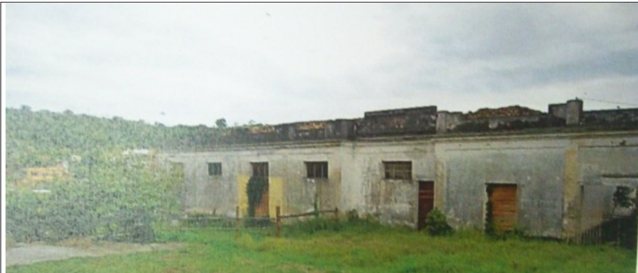
Figura 09- Vista Parcial da fachada principal da antiga Fábrica de Banha Didi. Fonte: Complementação do Processo de Tombamento- Bem Imóvel- Antiga Fábrica de Banha Didi, dezembro 2012- Exercício 2014. Documentação pesquisada junto ao IEPHA .
