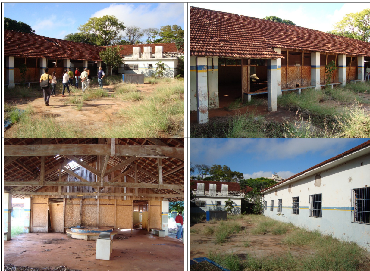
Figuras 17 a 20 – Atual estado de conservação do Instituto São Paulo Apóstolo.
