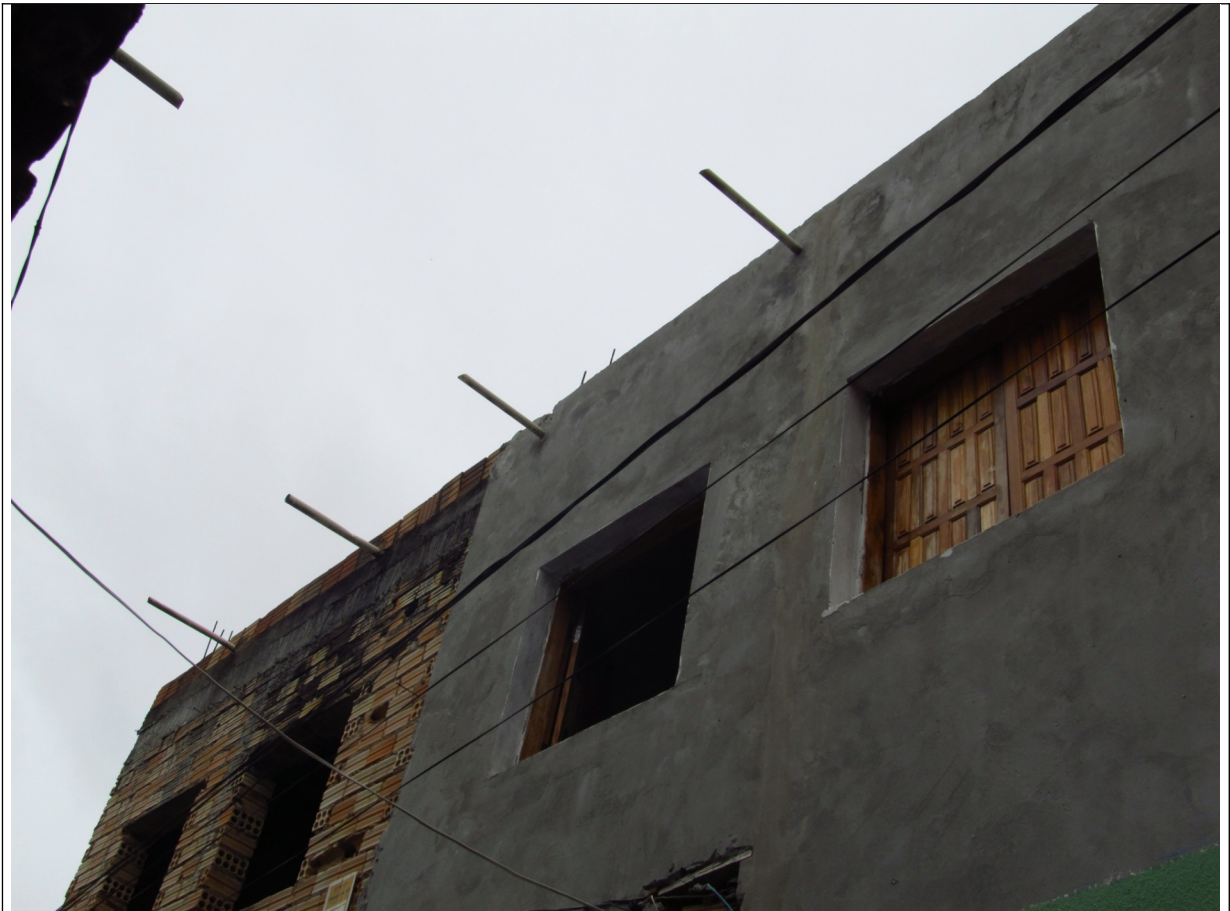
Figura 11 – Imóvel sem cobertura e com lançamento de águas pluviais diretamente na vi, de forma improvisada.
