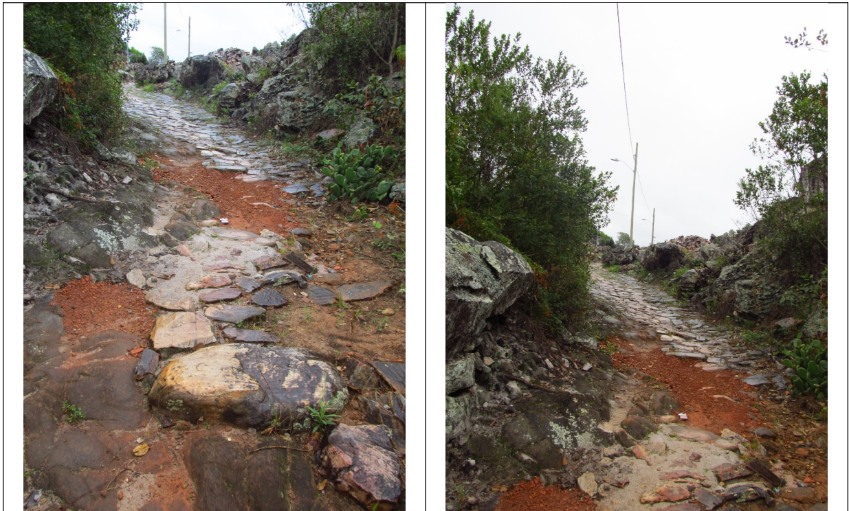
Figuras 30 e 31- Calçamento danificado na Trilha do Barão. Fotos da vistoria realizada pelo Setor Técnico desta Promotoria.
