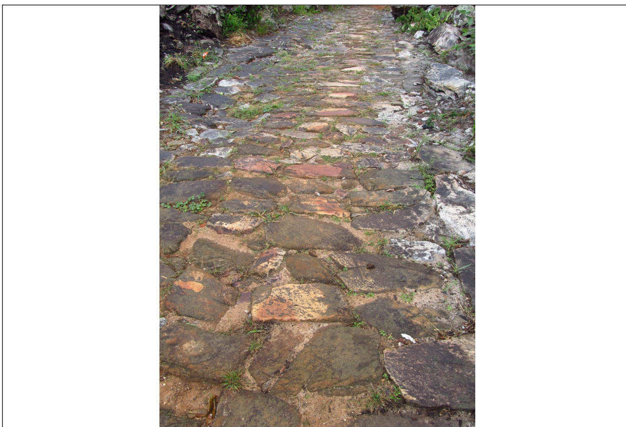
Figura 34- Calçamento da Trilha do Barão, num trecho que se encontra bem conservado. Foto da vistoria realizada pelo Setor Técnico desta Promotoria.
