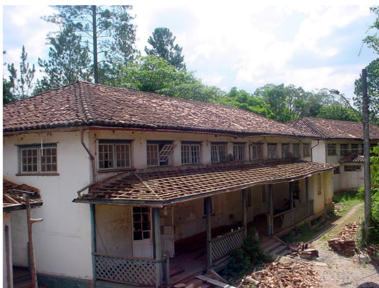
Figura 83 – Reforma no Hospital de Morro Velho no ano de 2004: fachada posterior Fonte: Centro de Memória Morro Velho, In DEOTTI, 2007.
