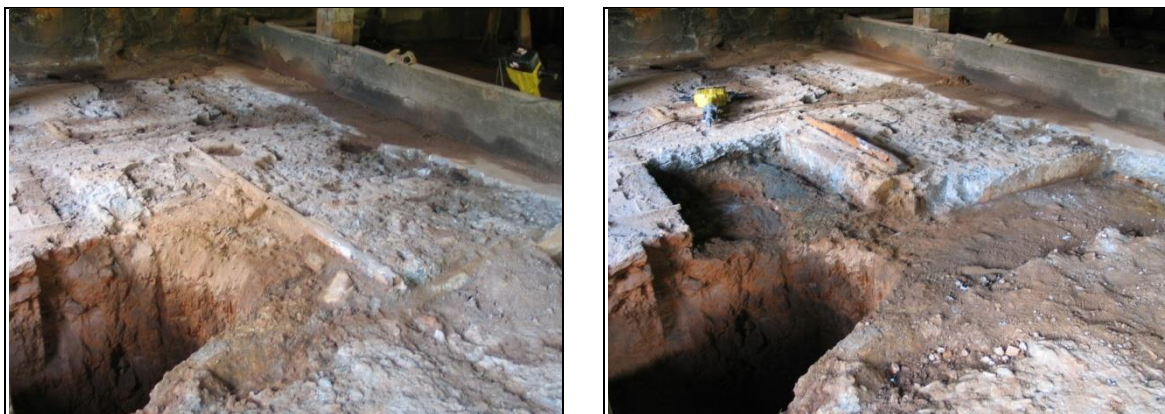
Figura 153 – Fotografias demonstrando a remoção da primeira camada de cimento (à esquerda), resultando em estruturas mais antigas deixadas in situ (à direita)
