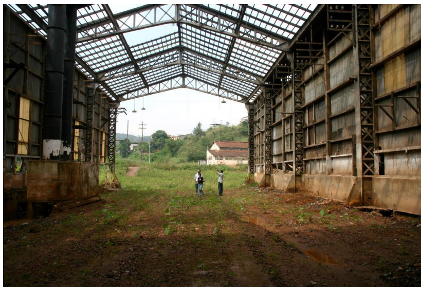
Figura 55 – Detalhe da estrutura metálica na cobertura e dos pilares de sustentação do prédio dos Compressores. Data: 2006 Fonte: Centro de Memória Morro Velho, In DEOTTI, 2007.
