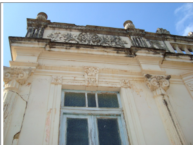
Figura 08 – Trincas e manchas de umidade.
