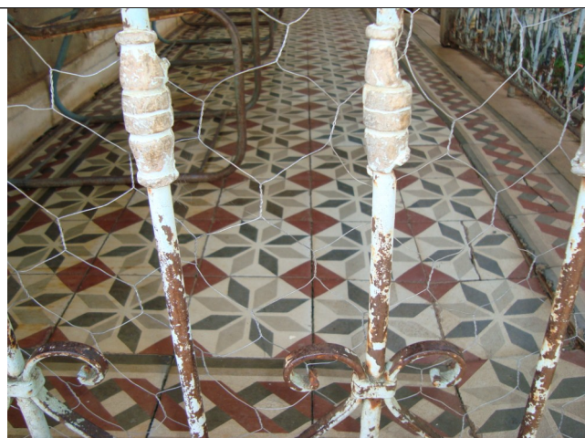
Figura 09 – Oxidação do gradil e instalação de tela metálica.
