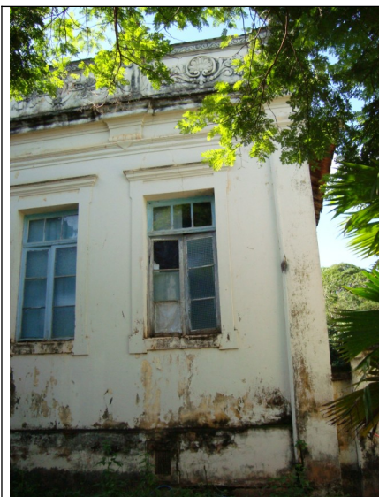
Figura 05 – Manchas de umidade e vidros quebrados.
