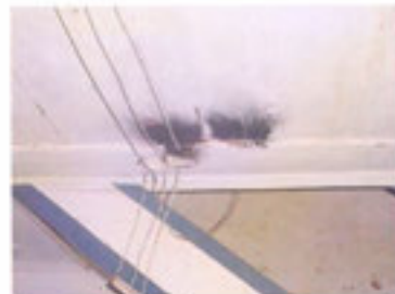
Emenda frouxa provocando curto-circuito
