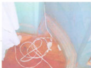
Fiação exposta e provisória
