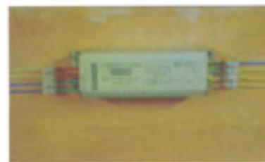
Reator instalado diretamente sobre madeira
