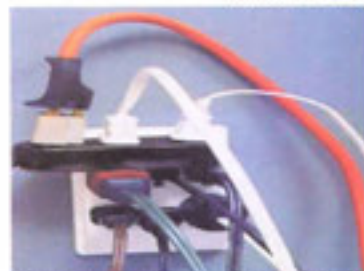
Tomada elétrica sobrecarregada
