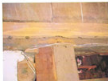
Conductor sem eletroduto
