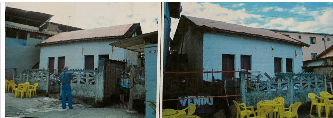
Figuras 04 e 05 : Imagens do imóvel nº 282, constantes do Laudo de estado de conservação de 2007.
