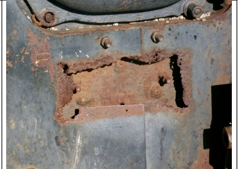
Figura 21 – Perda de material devido a oxidação e corrosão.
