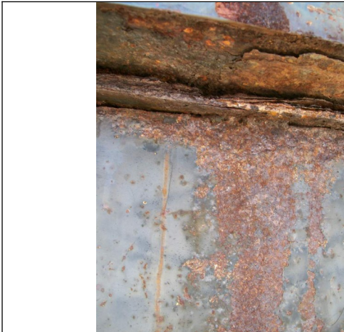
Figura 22 – Oxidação e corrosão.
