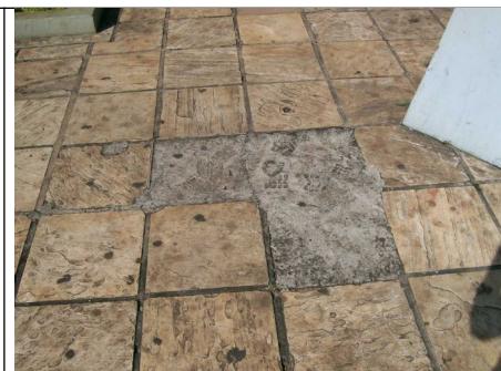
Figura 08 – Emendas no piso de pedra São Tomé.
