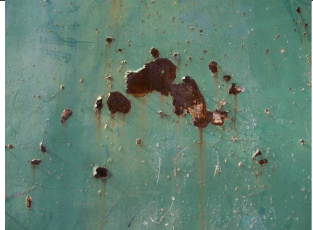
Figura 19 – Oxidação e descolamento da camada pictórica.
