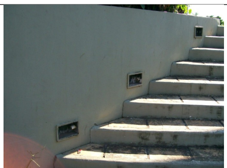
Figura 10 – Luminárias quebradas e sem lâmpadas.
