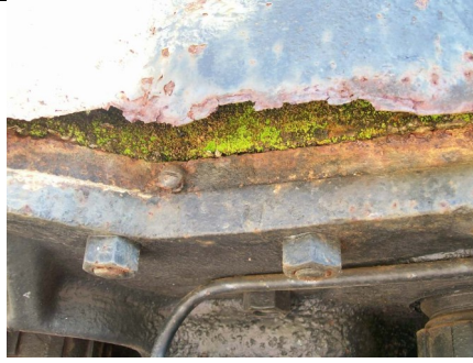
Figura 20 – Presença de musgos devido à umidade.
