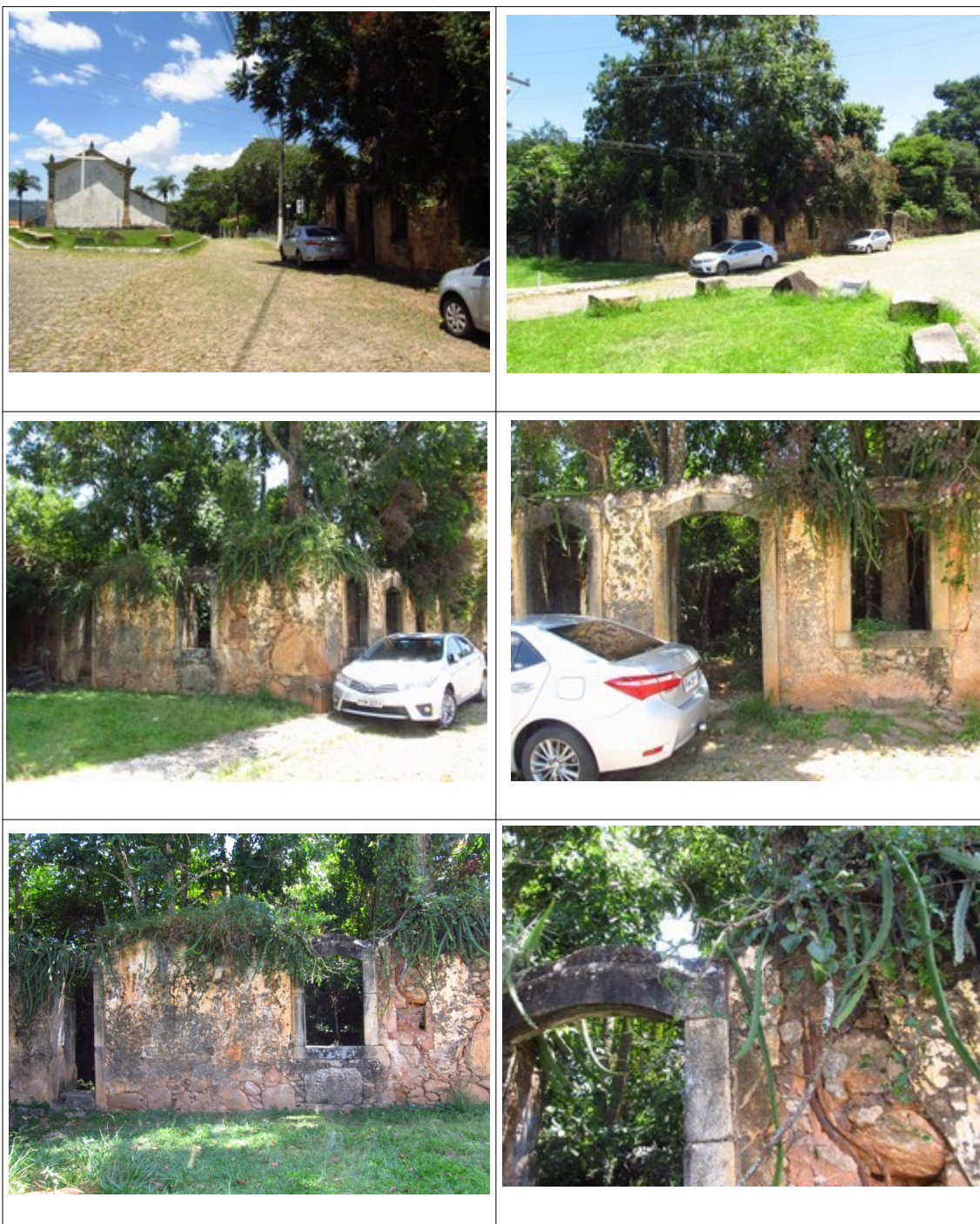
Figuras 26, 27, 28, 29, 30 e 31-Ruínas de edificação existente no entorno Capela do Senhor Bom Jesus do Matozinhos. Fotos da vistoria.
