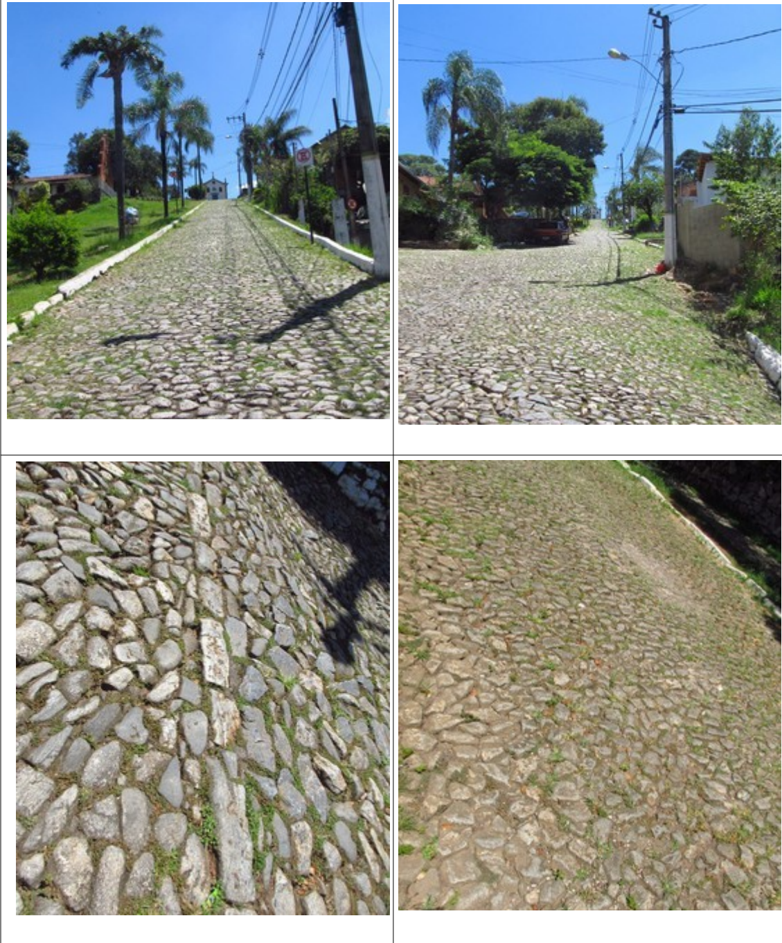
Figuras 6, 7, 8 e 9- Pavimentação em pedra tipo pé de moleque da Rua Matozinhos. Fotos da vistoria.
