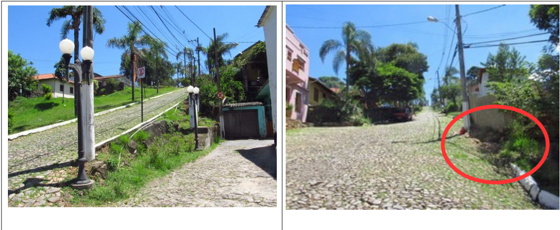
Figuras 45, 46 e 47- Presença de inscrições e pichações no trecho de muro de pedra que fica nas proximidades da edificação em ruínas e de trechos desmoronados, próximos à Capela das Mercês e no início da subida da Rua Matozinhos. Fotos da vistoria.
