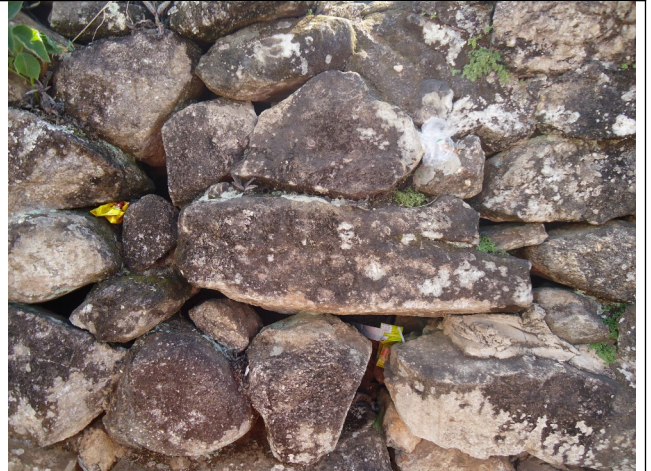
Figura 08 – Pedras soltas e lixo nos espaços existentes entre elas. Foto da vistoria de maio de 2013.
