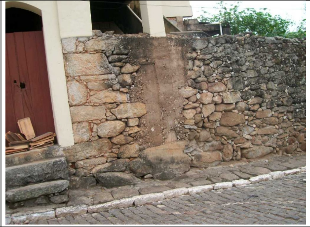
Figura 07 – Descaracterização devido a inserção do pilar.
