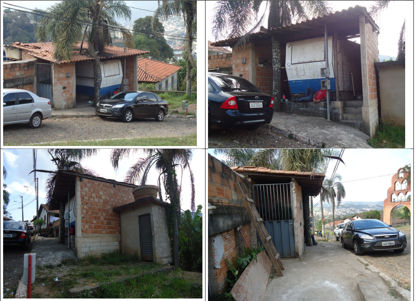
Figuras 04 a 07 – Imagens do trailer e instalação sanitária da vistoria de maio de 2013.
