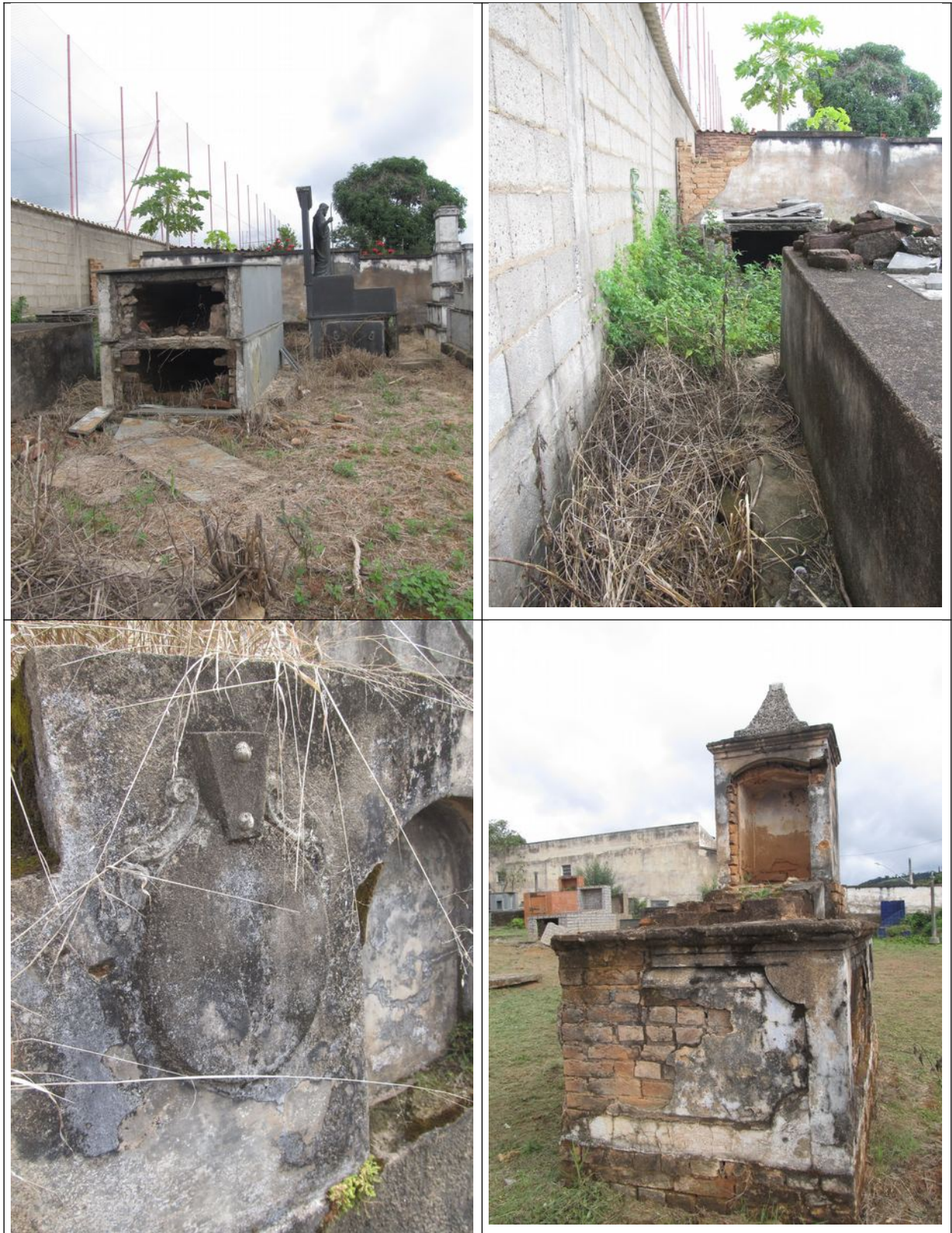
Figuras 15, 16, 17, 18, 19 e 20- Degradação dos túmulos no antigo Cemitério de Itaguara.
