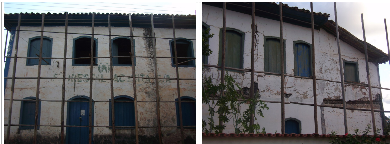
Figuras 01 e 02 - Vista das fachadas frontal e lateral, que mostram a presença de várias trincas e rachaduras, descolamento do reboco e manchas de umidade.
