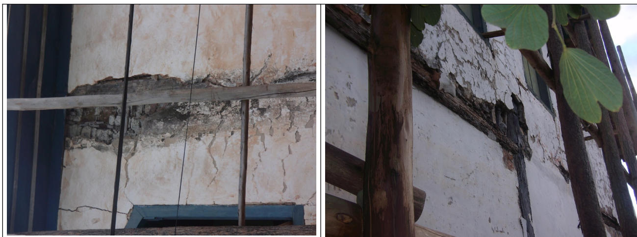
Figuras 03 e 04 – Descolamento do reboco e trincas na alvenaria.
