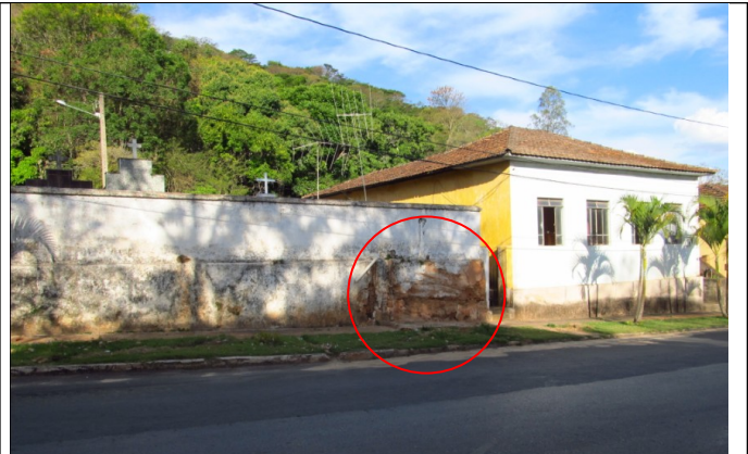
Figura 22- Muro atingido por um caminhão (assinalado de vermelho) em acidente recente no Largo de São Francisco. Fonte: Foto da vistoria de 16/10/2012
