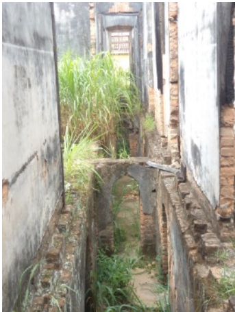
Figura 14 – O imóvel atualmente se encontra em estado de arruinamento.
