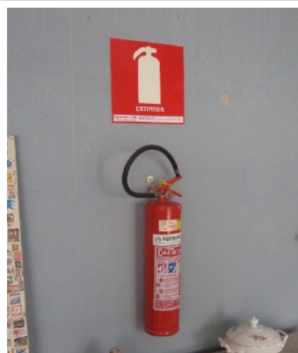
Figura 54 – Extintor de incêndio.
