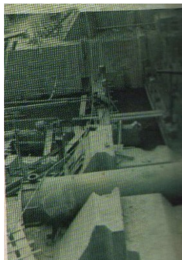
Figura 9 – Na cota 6 do paredão foi colocada uma tubulação com 20 metros de comprimento e 1 de diâmetro para nela se instalar a usina de propriedade da Itaunense, que recebeu o nome de Coronel Jove Soares Nogueira.
