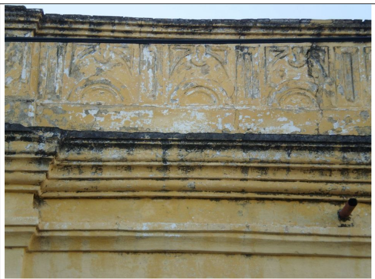
Figura 09 – Umidade junto à platibanda.
