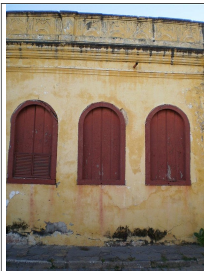
Figura 08 – Umidade junto à base.
