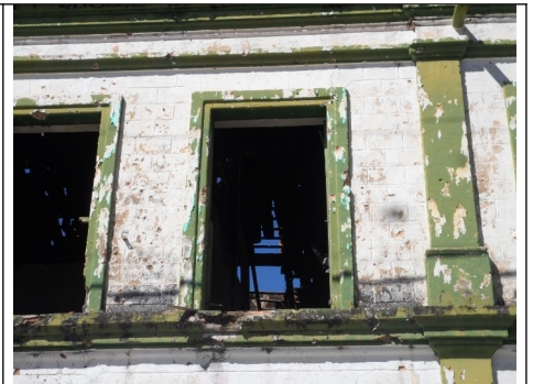
Figura 08 – Vão sem esquadria e destelhamento da cobertura.
