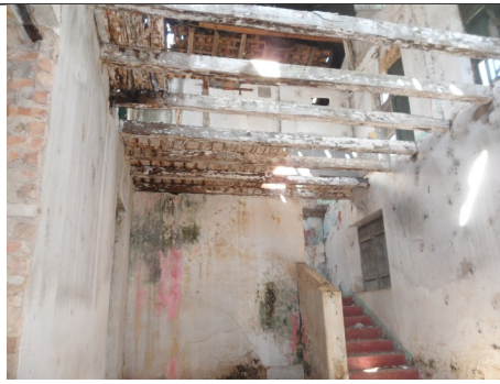
Figura 07 – Umidade junto à platibanda.
