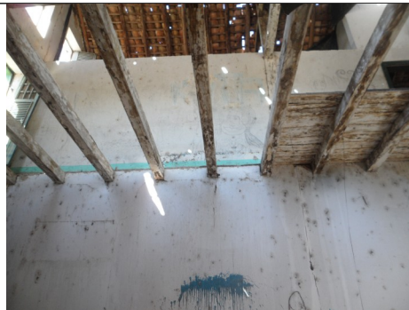
Figura 06 – Umidade junto à base.
