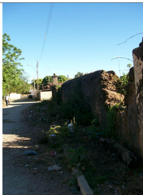
Figura 08 – Deve ser feita uma restauração no muro, com o intuito de preservar e proteger o bem cultural tombado de depredação.
