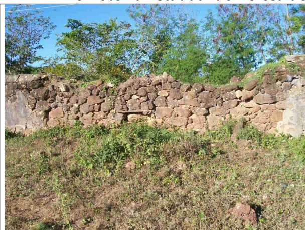
Figura 09 – Deve-se fazer uma restauração no muro de pedras com o objetivo de preservá-lo e proteger a parte interna do bem cultural.
