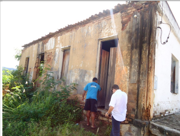
Figura 03 – Fachada lateral em péssimo estado de conservação e presença de mato no terreno adjacente.
