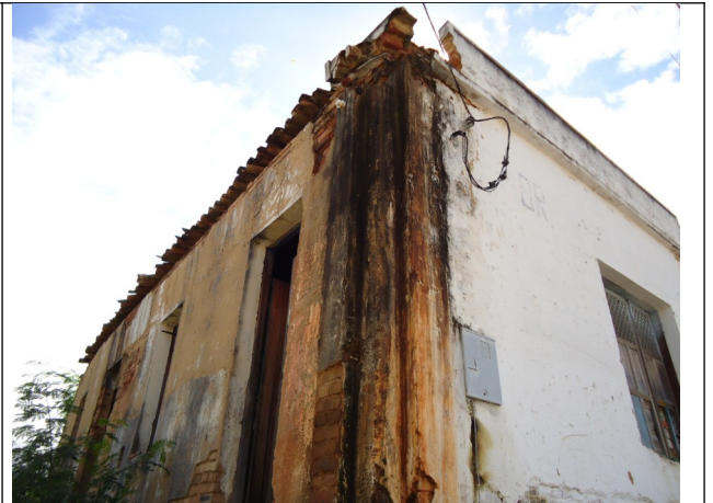
Figura 04 – Presença de trincas, descolamento do reboco e manchas de umidade nas alvenarias.
