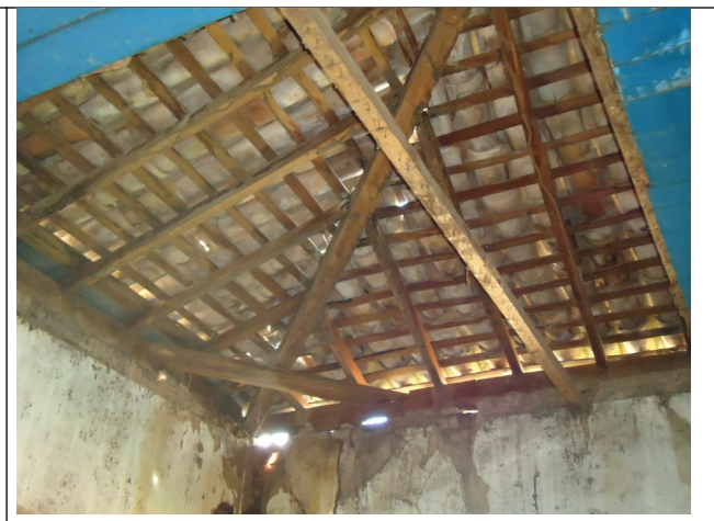
Figura 06 – Cobertura com patologias e danos no forro.
