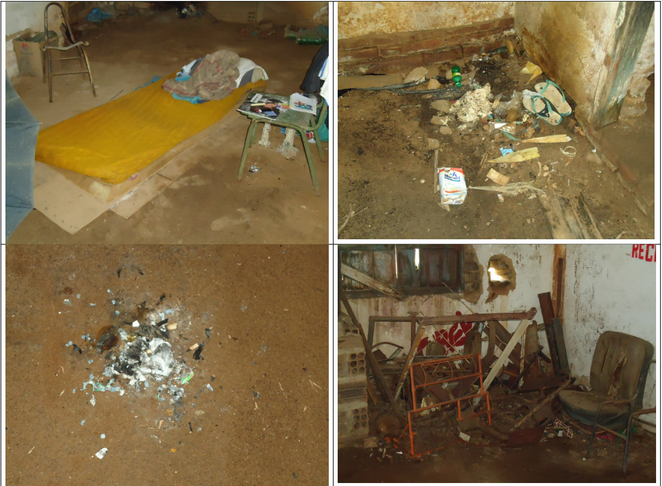
Figuras 07 a 10 – Indícios de ocupação humana e acúmulo de lixo no interior da edificação.
