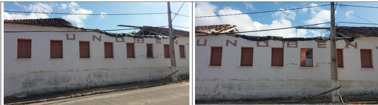
Figuras 7, 8 e 9- Imagens recentes do Prédio do Sindicato- UNOBENJE, destacando a parte da cobertura que ruiu.
