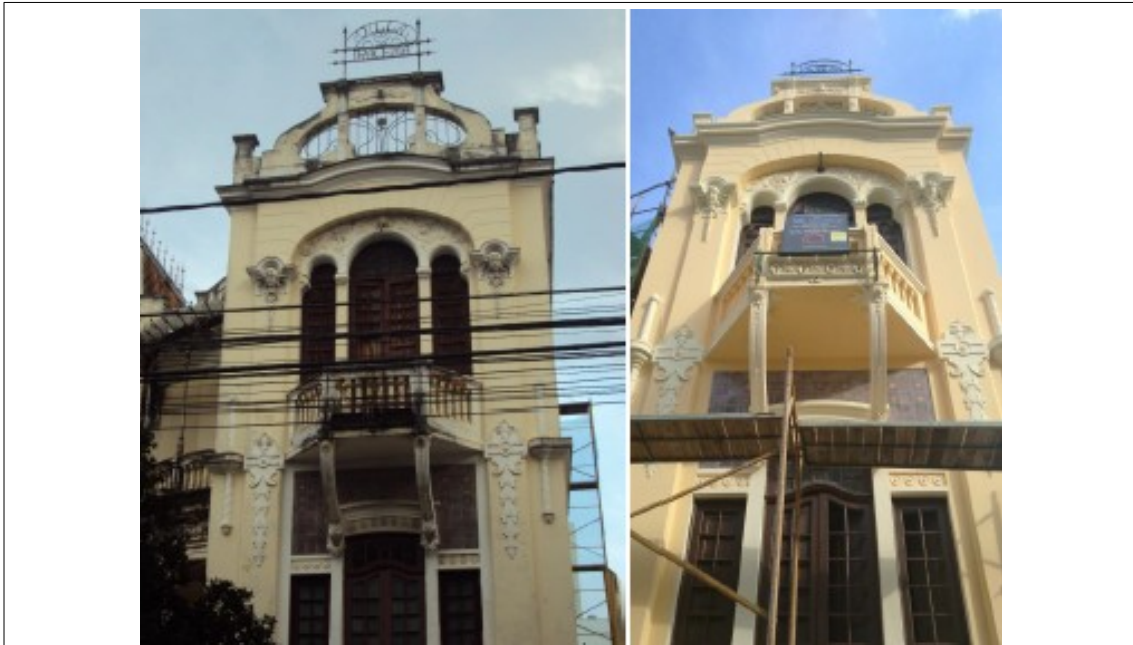
Figuras 02 e 03 - Fachada da edificação antes do início das obras e atualmente. Fonte: Laudo de vistoria da Funalfa - abril 2019.
