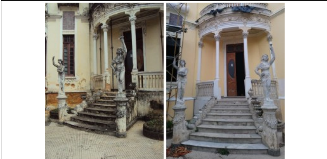
Figuras 04 e 05 - Escadaria de acesso antes do início das obras e atualmente. Fonte: Laudo de vistoria da Funalfa - abril 2019.
