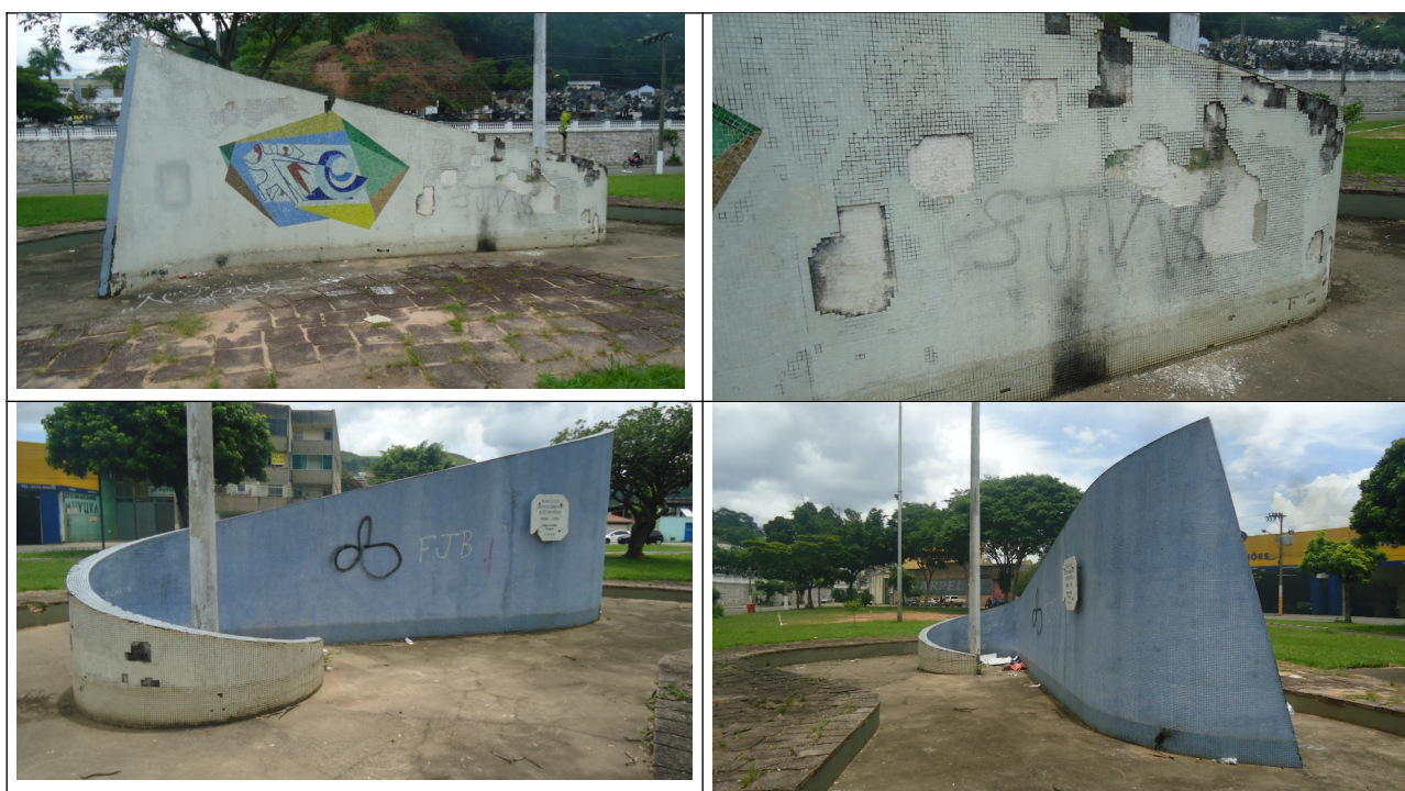
Figuras 08 a 11 – Imagens do estado de conservação do monumento.
