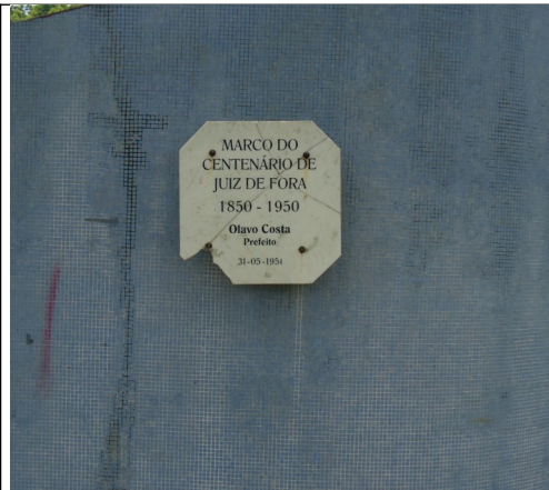
Figura 13 – Placa comemorativa de mármore danificada.
