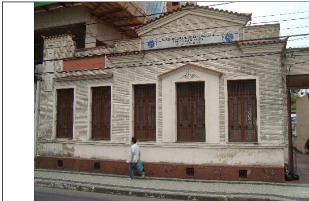
Figura 08 – Fachada frontal da edificação. Foto contida no CD encaminhado pelo IBRAM em dezembro de 2011.
