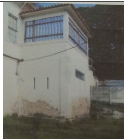
Figura 09: Detalhe da varanda do prédio anexo vedada por telhas metálicas, sendo observado descascamento do reboco em sua base. Fonte: Laudo técnico do estado de conservação, 2010.
