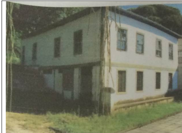
Figura 06: Vista das fachadas frontal e lateral da sede onde percebe-se madre com ataque de insetos xilófagos, janela vedada com madeira, pintura descascando e janelas sem vidros. Fonte: Laudo técnico do estado de conservação, 2010.
