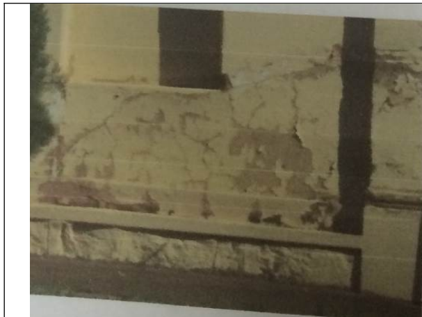
Figura 08: Detalhe da base do pavimento térreo, sendo observado descascamento da pintura. Fonte: Laudo técnico do estado de conservação, 2010.
