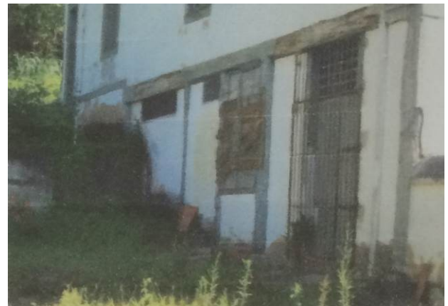
Figura 07: Detalhe da fachada lateral direita da sede, onde nota-se vedação da janela, no térreo, com réguas de madeira, além da madre com ataque de insetos xilófagos. Fonte: Laudo técnico do estado de conservação, 2010.
