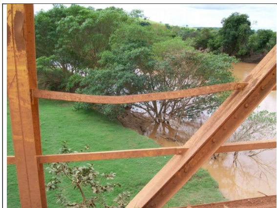
Figura 15 – Guarda – corpo com peças metálicas retorcidas.
