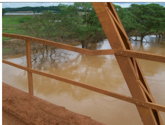
Figura 16 – Guarda – corpo com peças metálicas retorcidas.
