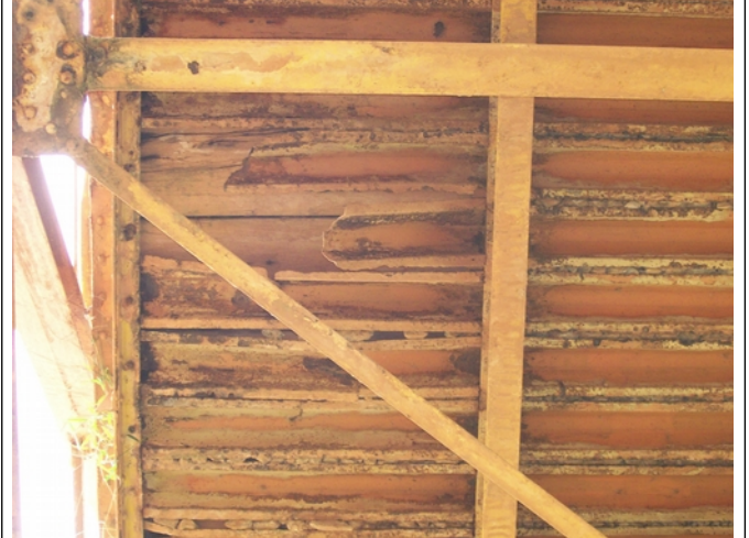
Figura 24 – Barrotes metálicos enferrujados que se romperam e “emenda” com tábuas de madeira.
