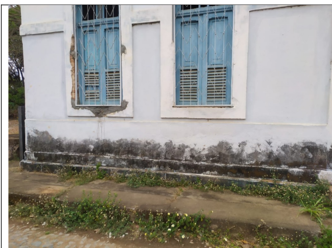
Figura 06 – Manchas de umidade junto a base e presença de plantas invasoras na calçada.
