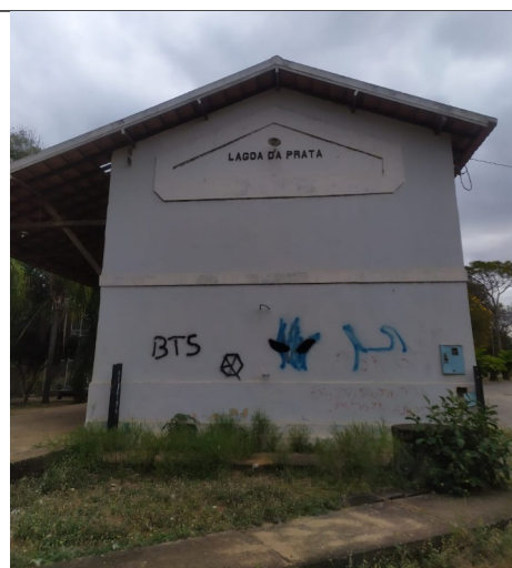
Figura 07 - Pichações na fachada lateral.
