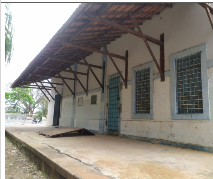
Figura 08 – Fachada frontal com inserção de grades defronte aos vãos.
