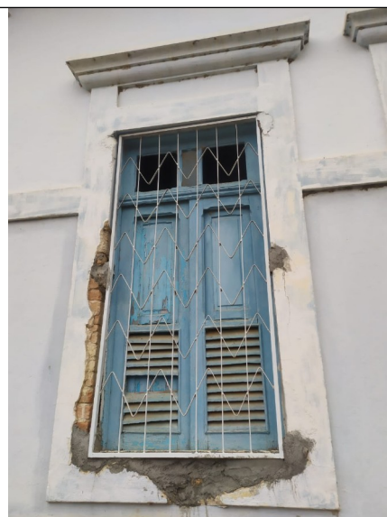
Figura 09 – Inserção de grade, comprometimento das esquadrias e descolamento de reboco.
