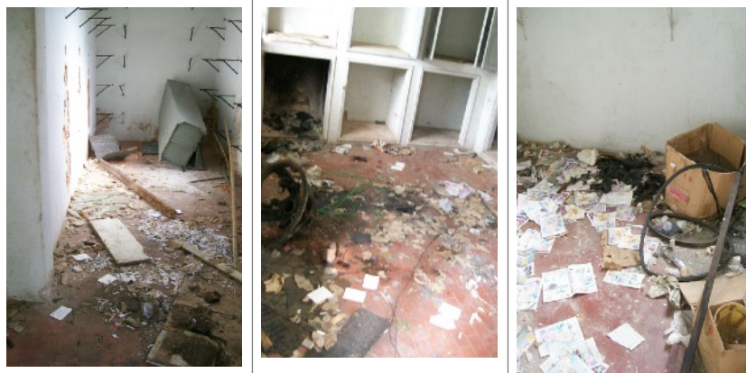
Figura 40 a 42 – Acima interior do prédio. No interior do imóvel observa-se grande quantidade de entulho.
