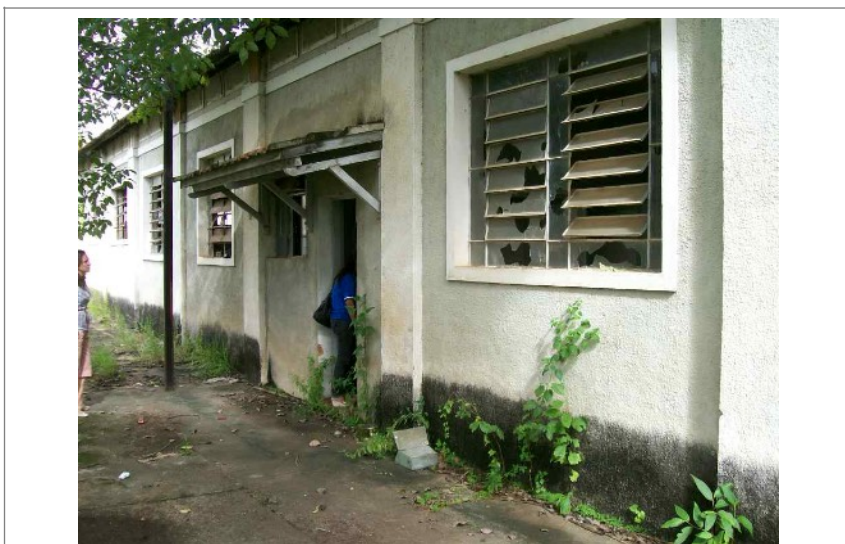
Figura 39 – Acima parte externa do prédio. O imóvel está completamente abandonado, assim como os outros pertencentes ao Complexo Ferroviário, apresentando vidros quebrados nas janelas e descuido no que se refere à vegetação ao redor do mesmo.
