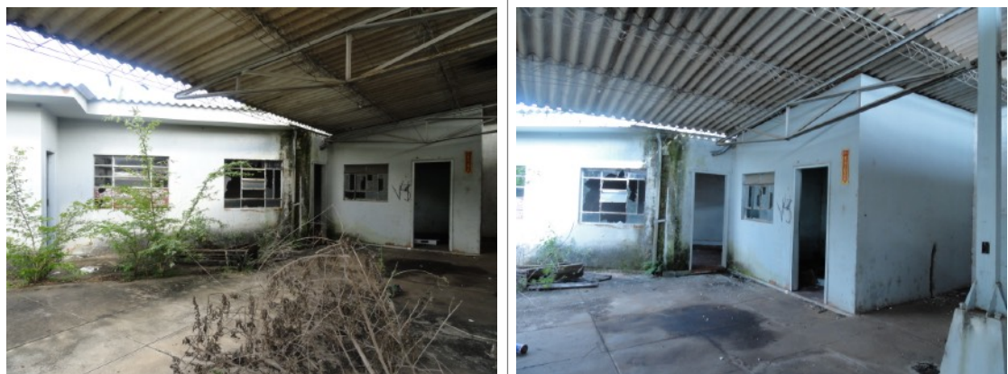
Figura 35 e 36 – Acima à esquerda fachada prédio, acima à direita detalhe da fachada mais à direita.
