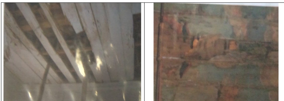
Figura 13 - Forros em péssimo estado de conservação. Fonte: IPAC municipal – 2005.
