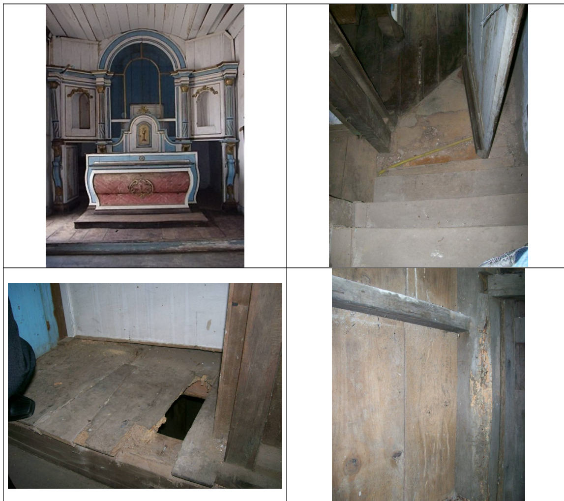
Figura 17 a 20 – Acima visão geral do retábulo e pormenores por meio dos quais é possível verificar o estado de conservação do bem integrado que se encontra na ala esquerda da igreja.
