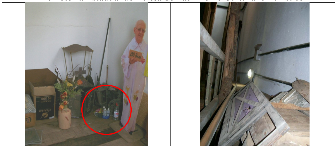
Figuras 21 a 24 – Na página anterior verifica-se o acúmulo de materiais no interior da igreja. Observa-se que se tratam de materiais inflamáveis. Em destaque agarrás e demais produtos químicos (figura 23). Fonte: Promotoria de Patrimônio Cultural.
