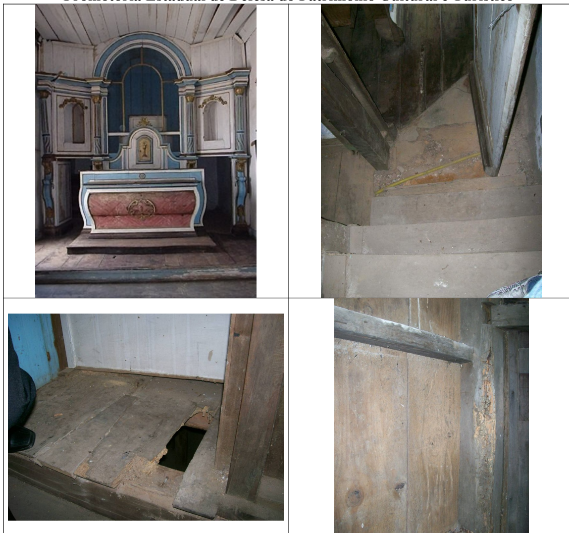
Figura 26 a 29 – Acima visão geral do retábulo e pormenores por meio dos quais é possível verificar o estado de conservação do bem integrado que se encontra na ala esquerda da igreja. Fonte: Promotoria Estadual de Defesa do Patrimônio Cultural e Turístico de Minas Gerais.
