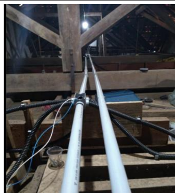
Figura 6 – Vista das instalações elétricas sobre a cobertura.
