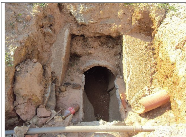
Figura 11 – Ala de canal de drenagem soterrada.
