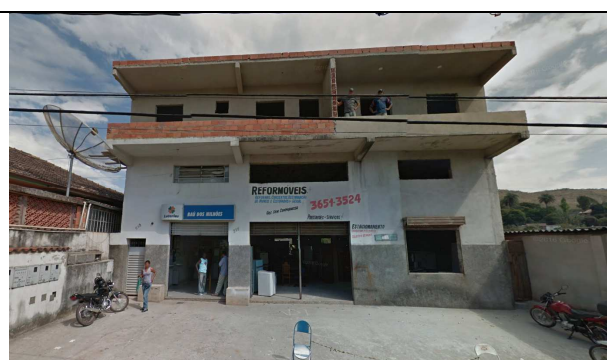
Figura 07 – Imagem do imóvel no ano de 2011 com a segunda parte sendo executada sem aprovação. Fonte: google maps.
