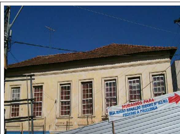
Figuras 07- Imagem da lateral do casarão voltada para Rua 7 de Setembro feita no dia da vistoria.
