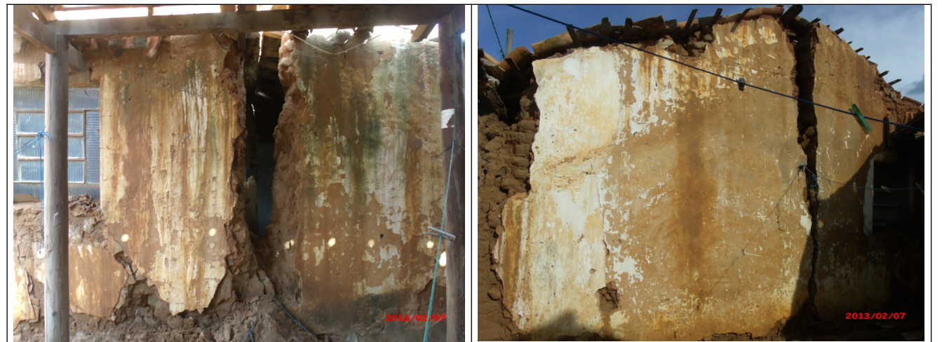
Figuras 08 e 09 – Trincas profundas nas alvenarias remanescentes.
