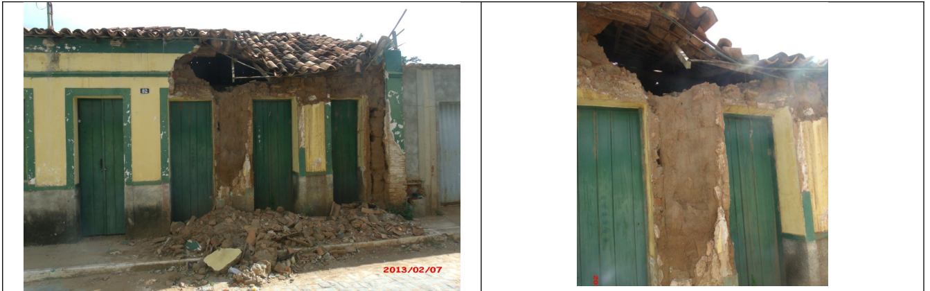
Figuras 06 e 07 – Detalhe do trecho arruinado.
