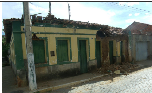
Figura 05 – Fachada lateral em processo de arruinamento.
