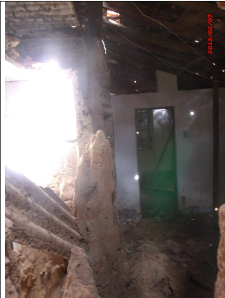
Figura 10 – Arruinamento de alvenaria interna.
