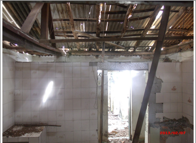
Figura 11 – Cobertura de telhas de amianto também comprometida.
