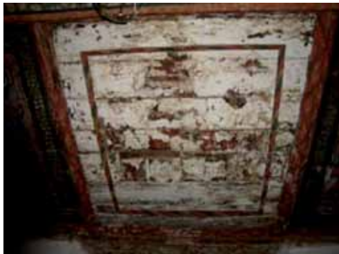
Forro com perdas na policromia Fonte: projeto de restauração da Capela do Rosário de Chapada do Norte Autor: Daniele Gomes
