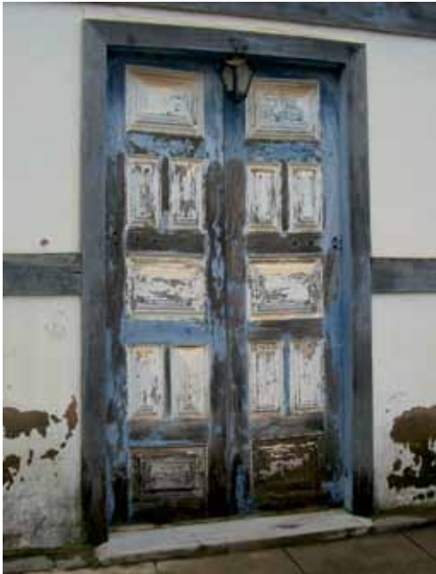
Esquadria com descolamento de pintura Fonte: Igreja do Rosário, em Piranga Autor: Andréa Lanna - MPMG
