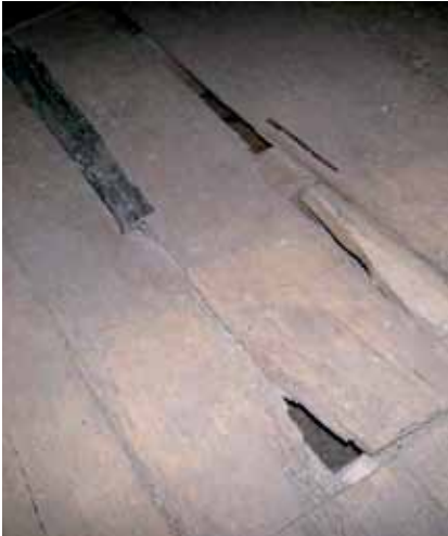
Piso de madeira danificado e com presença de cupim Fonte: Igreja Matriz de Congonhas Autor: Andréa Lanna - MPMG
