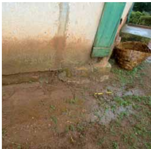
Acúmulo de água junto à base da edificação Fonte: Capela Nossa Senhora do Rosário de Rio Vermelho. Autor: Andréa Lanna - MPMG
