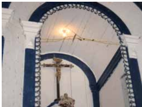
Fiação exposta, com emendas, instalada diretamente no elementos de madeira Fonte: Capela do Senhor Bom Jesus da Lapa, em Chapada do Norte Autor: Alexandre Novaes - IEPHA-MG
