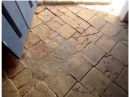
Piso em mezanolo danificado Fonte: projeto de restauração da Capela do Rosário, em Chapada do Norte Autor: Daniele Gomes
