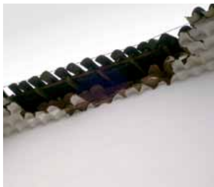
Danos no beiral
