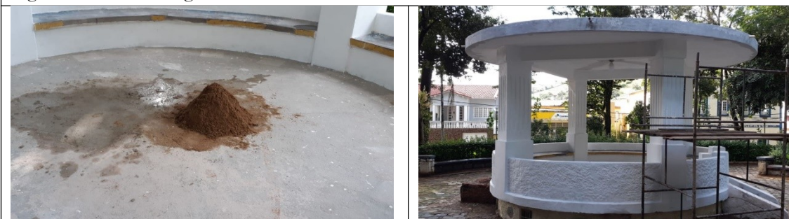
Figuras 19 e 20 – Material de construção e andaime o que demonstra que as obras estão em andamento.
