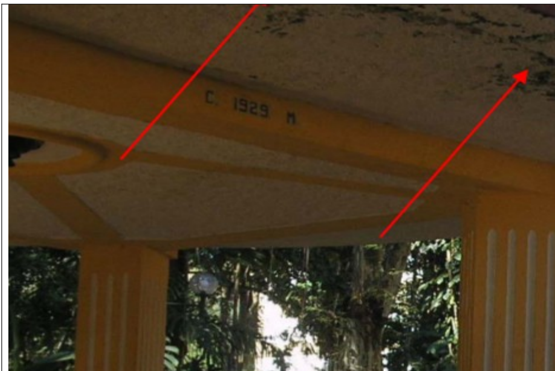
Figura 09 – Imagem das infiltrações na laje do coreto quando da elaboração do Dossiê de Tombamento.
